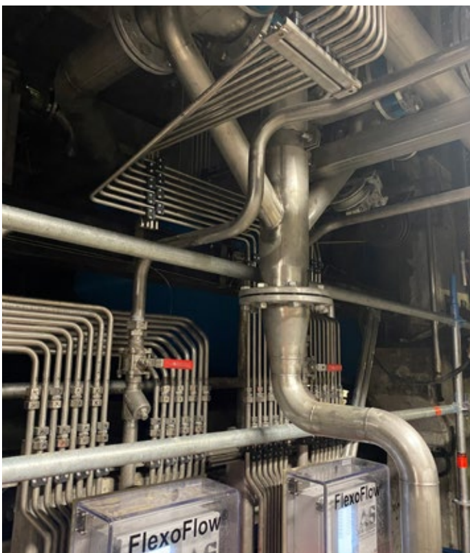
Abb. 6: Verrohrung der Durchflussregler
