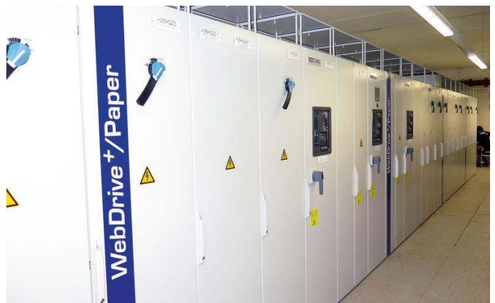
Blick auf die neue MMA-Schaltanlage der PM3.
