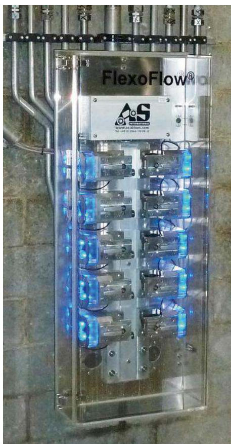
FlexoFlow®Water zur Kühlwasserversorgung der Synchronmotore.
