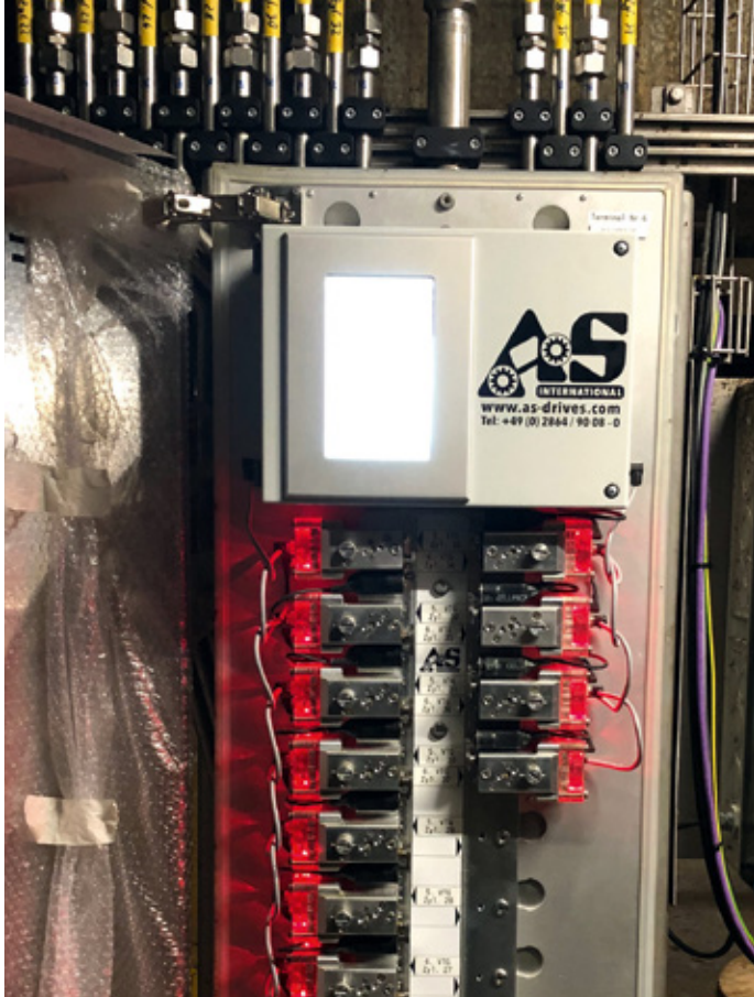
Abb. 6: FlexoFlow® Durchflussregler unmittelbar vor der Inbetriebnahme
