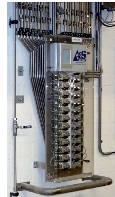
FlexoFlow Terminal zur Versorgung der Lagerstellen
